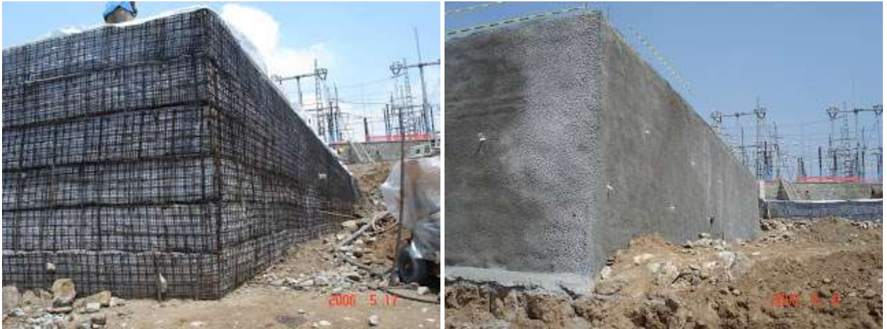
Fig. 9 MEM con canastilla metálica y arropes antes y después de la fachada de concreto lanzado.
