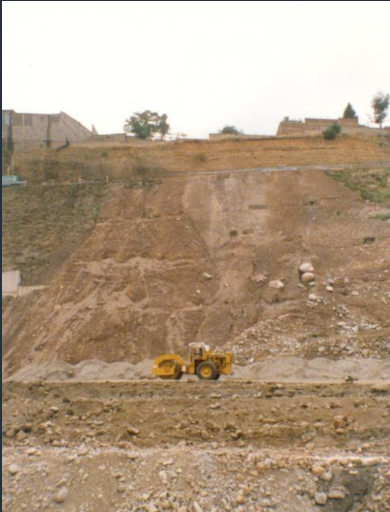
1992 Falla de talud Época de lluvias muy intensas.
